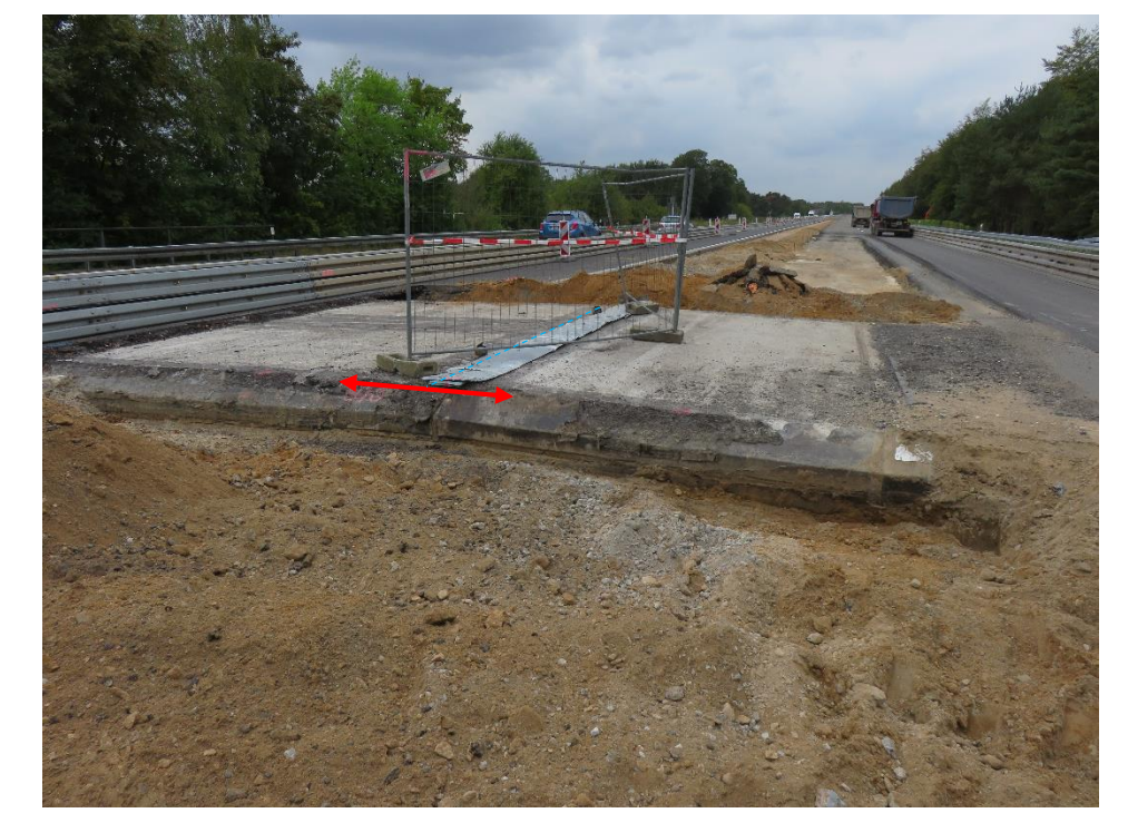
Abbildung 10: Fuge wurde mit Styrodur und Blech abgedeckt, weitere Arbeiten am Bauwerk vorerst eingestellt.
